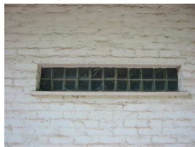
Saunan ja pesuhuoneen ikkuna, alkuperäiset puuikkunat i 7 ja i 8 korvattu lasitiili-ikkunalla kun seinän rakene muutettiin hirsiseinästä tiiliseinäksi
